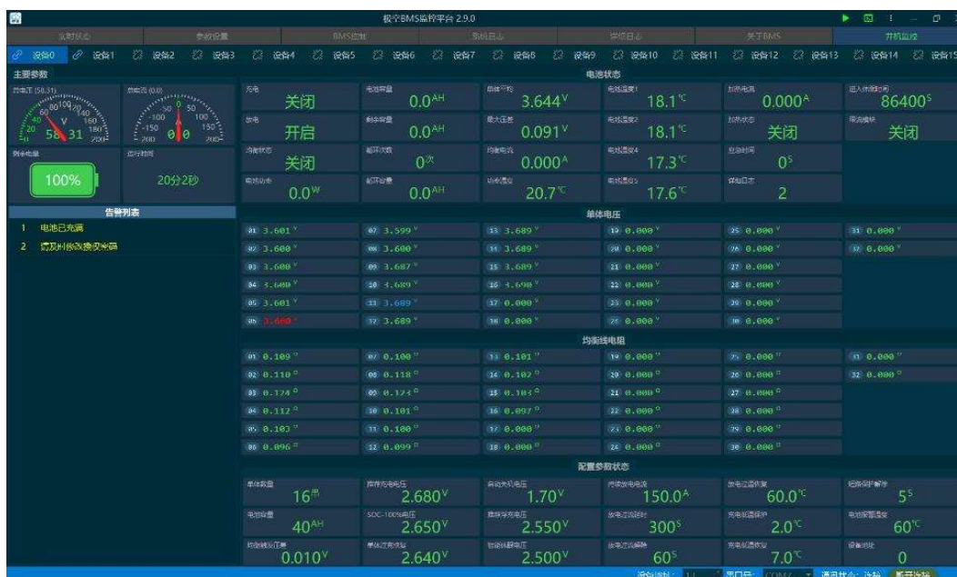
Widok monitorowania BMS nr 1
